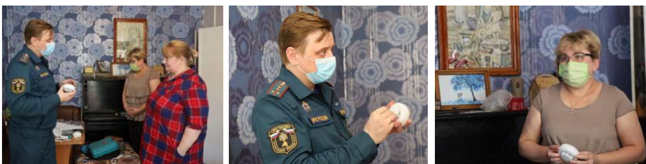
На фото: сотрудник Государственного пожарного надзора В.Н. Пантевич устанавливает пожарный извещатель в квартире многодетной интинской семьи; специалист администрации МОГО «Инта» Н.А. Сафарова проводит инструктаж.
